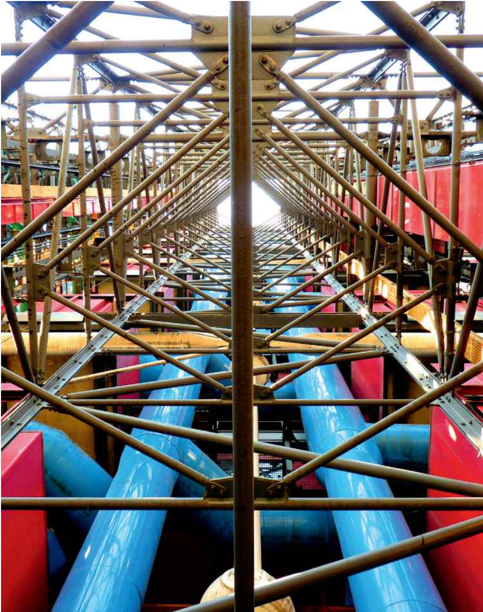
Détail de la structure du Centre Pompidou © Centre Pompidou / Photo : Philippe Migeat
